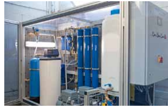
Wasseraufbereitung auf wenigen Quadratmetern – das kompakte Herzstück wartungsarm
